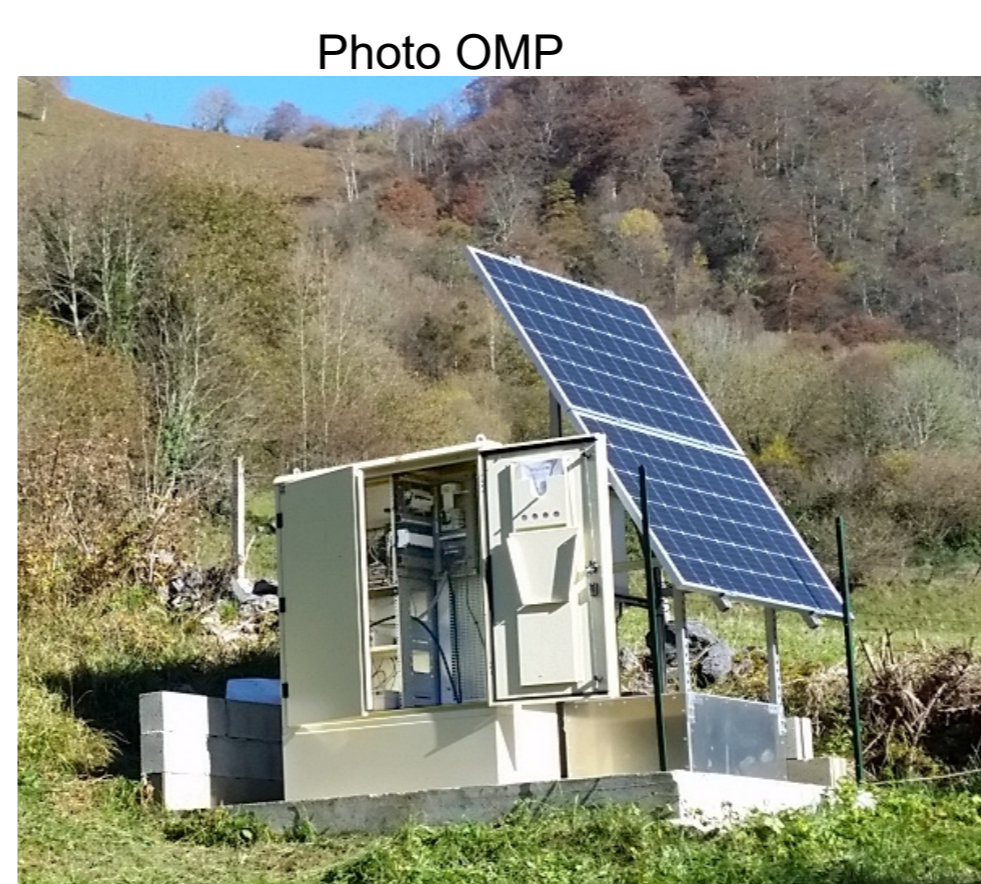
Station du Castet (REYF) dans les Pyrénées (infrastructure solaire Bleu Ciel Energie).
